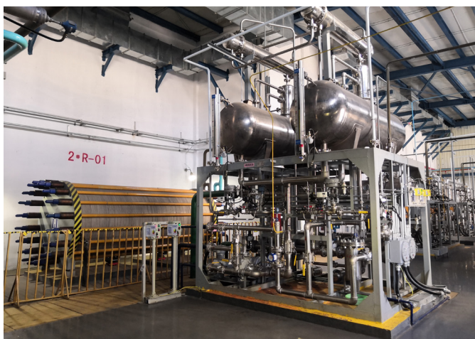
Figure 12 : Electrolyseur Alcalin 5MW + Unité de séparation gaz/liquide – Copyrights “John Cockerill”
